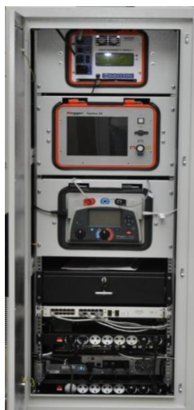
Вид со стороны измерительных приборов электрических параметров
